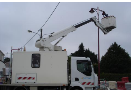
4- Installation de nouveaux candélabres et dépose des réseaux aériens et des supports
